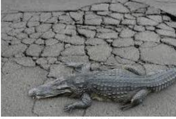
Şekil 1. Yorulma Çatlakları (Timsah Sırtı Çatlakları )
