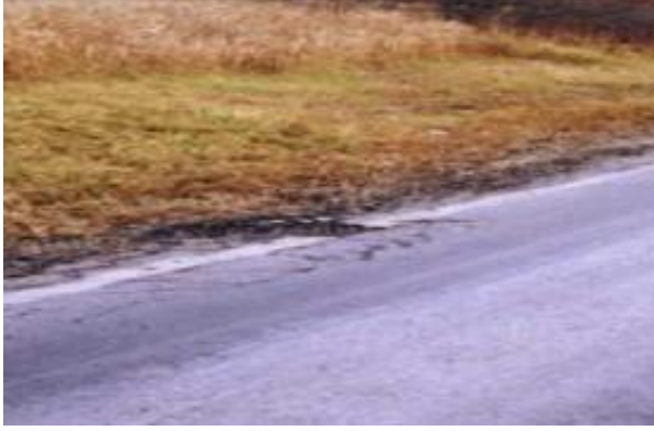
Şekil 3. Boyuna ve enine çatlaklar
