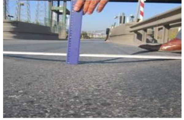
Şekil 4. Tekerlek izi oluşumu
