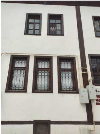
Fotoğraf-7: Doğalgaz hattı
