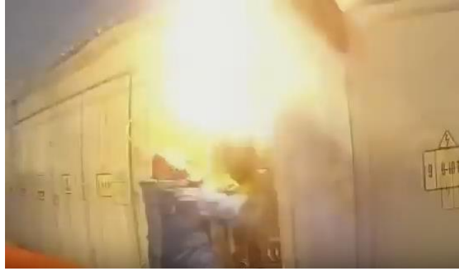
Şekil 1 Servis bakımı esnasındaki trafo patlama anı
